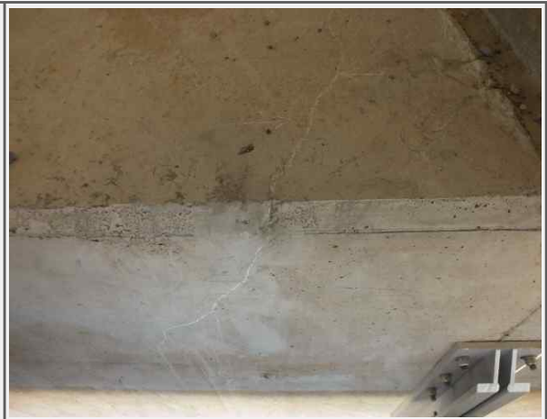
내 용 P6 코핑부 균열 (cw=0.2mm)
