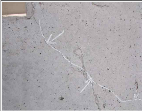
내 용 P5 코핑부 균열 (cw=0.3mm)
