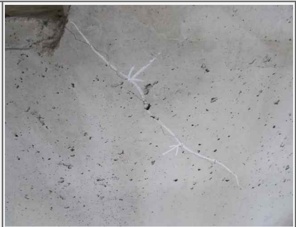
내 용 P4 코핑부 균열 (cw=0.3mm)
