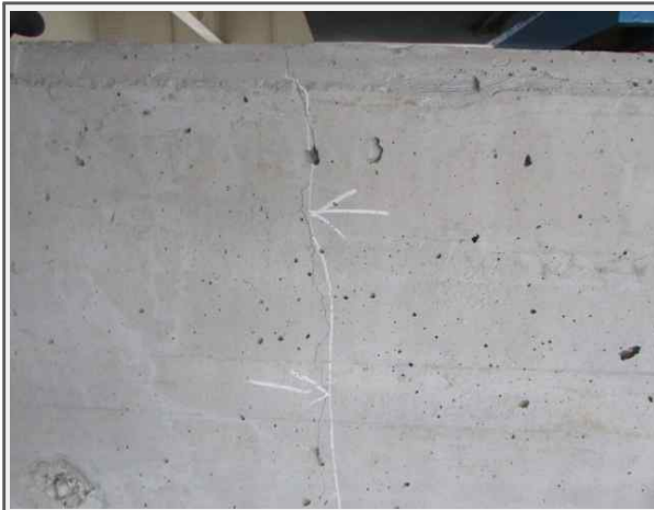
내 용 P3 코핑부 균열 (cw=0.3mm)
